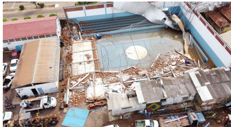
Três Ranchos foi atingido por forte chuva e ventos de até 80 km/h que causaram destruição
